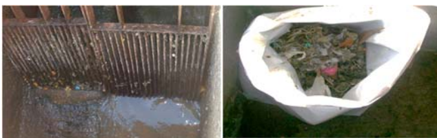
Figura 23 - Resíduos Sólidos interceptados na etapa de gradeamento do processo de tratamento de esgoto.
